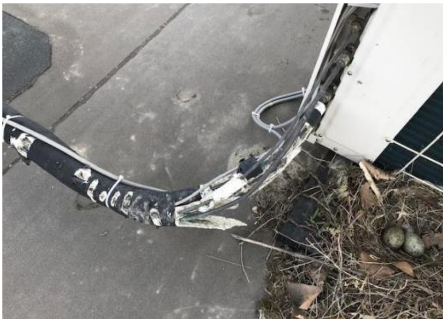
Figuur 3.5 Nest kleine mantelmeeuw bij airco unit op dak waar de meeuw de bekabeling heeft aangepikt
